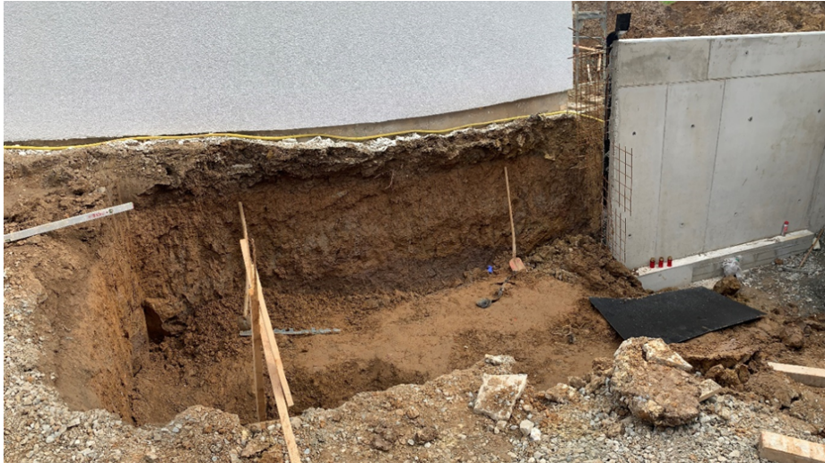
Bild: Tödlicher Unfall in einer Baugrube
