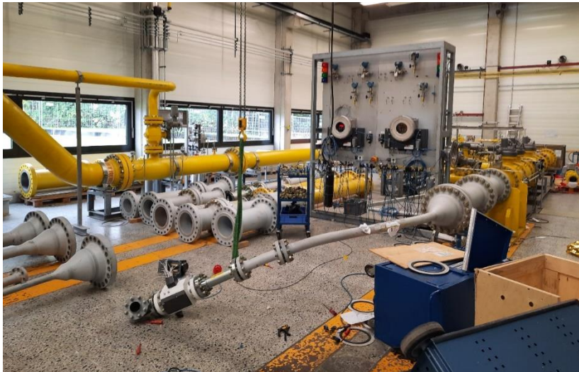
Bild: Prüfhalle Hochdruck-Zählerprüfstand
